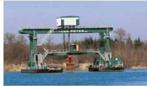
Die Firma Hermann Peter KG in Breisach-Niederrimsingen hat in seiner Schwimmbaggeranlage einen 13,5 m 3 umfassenden Seilgreifer von Kröger im Einsatz. Das Gerät zieht pro Hub eine ganze Lkw-Ladung an die Oberfläche.
